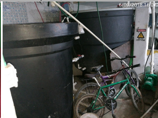
Foto No. 5 Sistema de tratamiento de ARnD.
